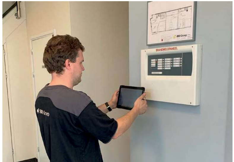
△ Een monteur van BRL inspecteert met een tablet de brandmeldinstallatie.
